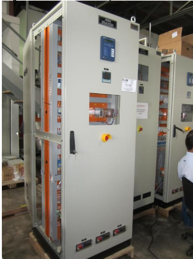
Figura 4 – Local De Fabricação Do Painel Elétrico.
