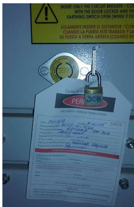
Figura 8 – Bloqueio elétrico e cartão de sinalização Fonte: Fotografia registrada pelo autor
