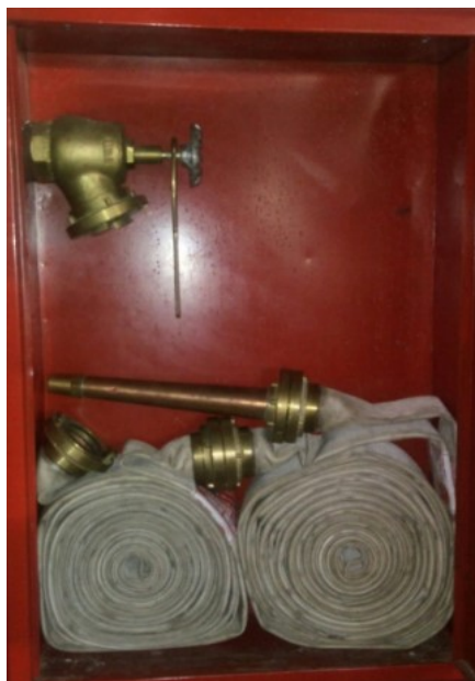
Figura 1 – Hidrante existente na edificação. Fonte: Autora, 2017.
