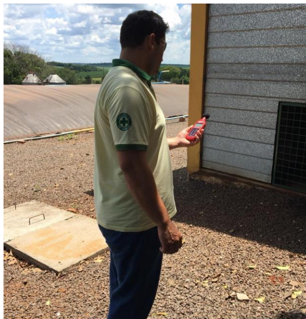
Figura 4. Medição saída do escapamento do motor-gerador.
