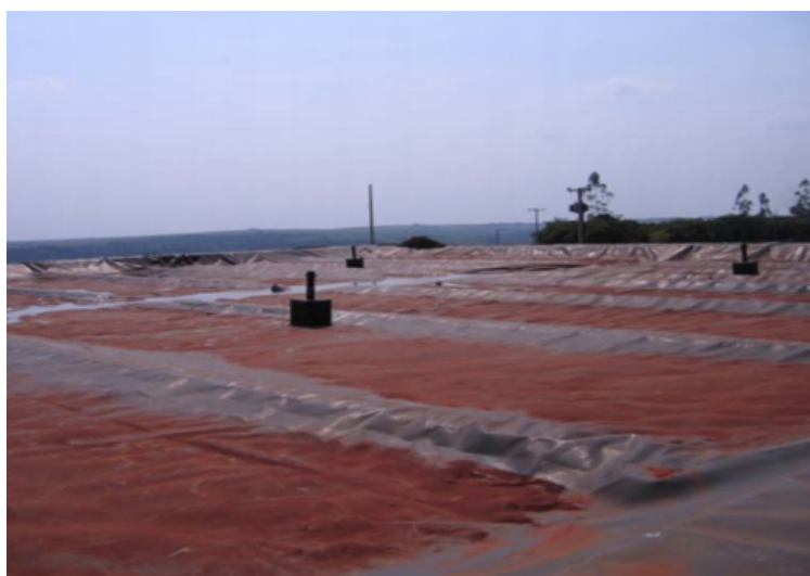
Figura 7: Lona sendo instalada no Biodigestor da Usina Ester Fonte: Panorama do Biogás no Brasil – Setor Sucoalcooleiro (MME, 2016)
