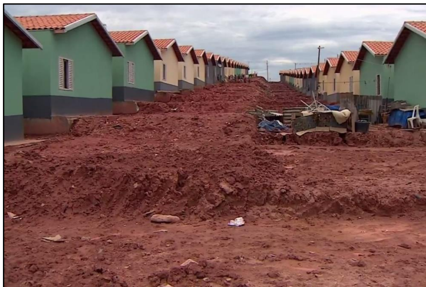
Figura 24 – Obras inacabadas do loteamento Pinheirinho dos Palmares
