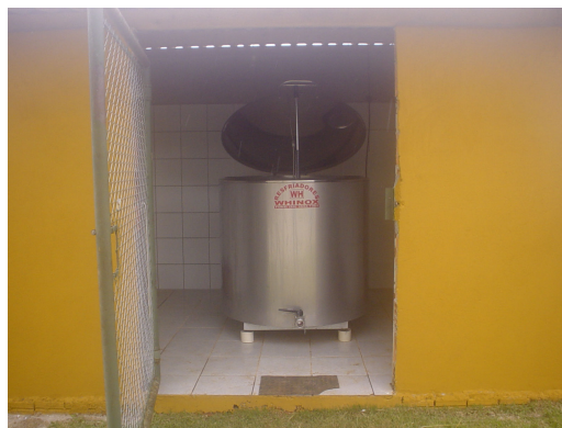
Figura 2 – Tanque instalado no Bairro Gramadinho.
