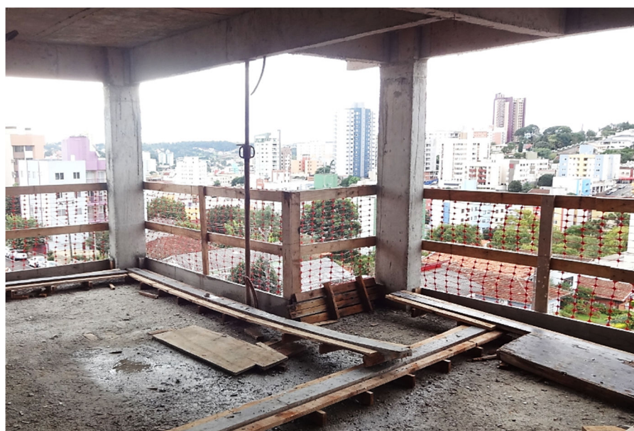
Fotografia 7 - Detalhe do guarda-corpo instalado no perímetro do edifício
