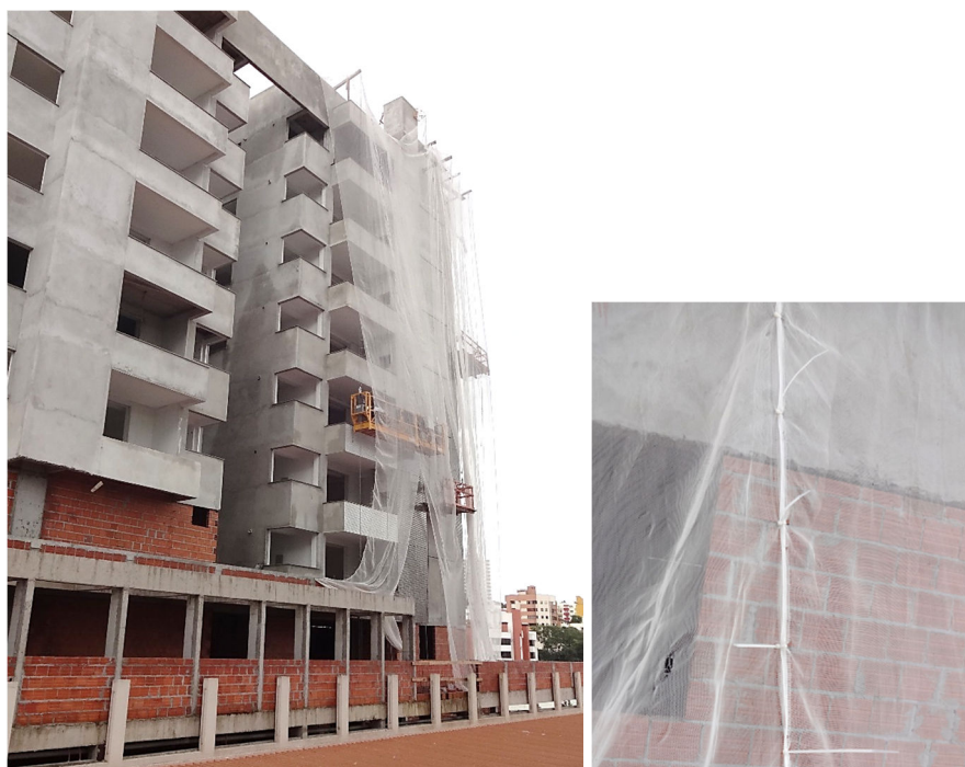
Fotografia 10 - Rede de proteção colocada sobre o balancim que estava executando serviços na fachada do edifício e as emendas que são feitas na rede
