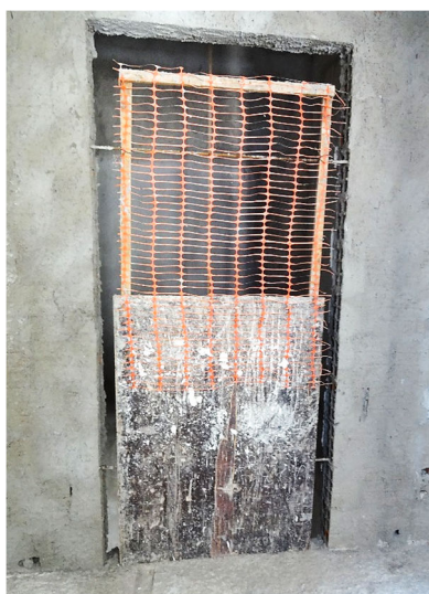
Fotografia 5 - Unidade de proteção em um vão do poço do elevador
