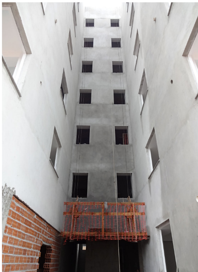
Fotografia 11 - Balancim para execução de trabalhos em fachada e a corda a ser utilizada pelo trabalhador para prender seu equipamento
