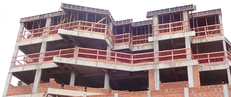
Fotografia 8 - Vista externa do guarda-corpo instalado no perímetro do edifício Fonte: O autor (2014).
