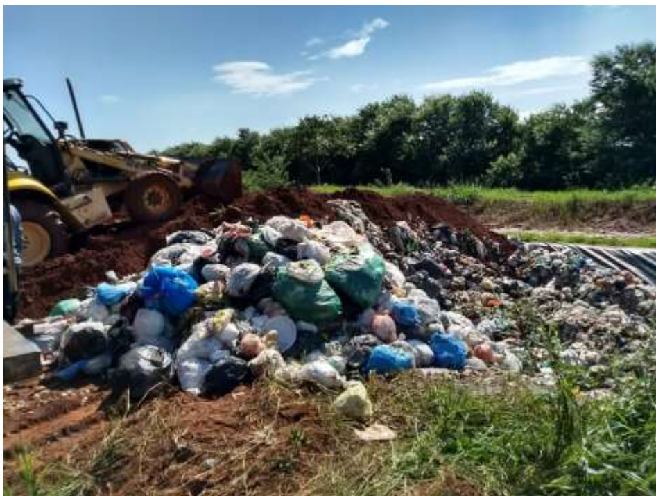
Figura 7 Resíduos que caíram na borda da trincheira
