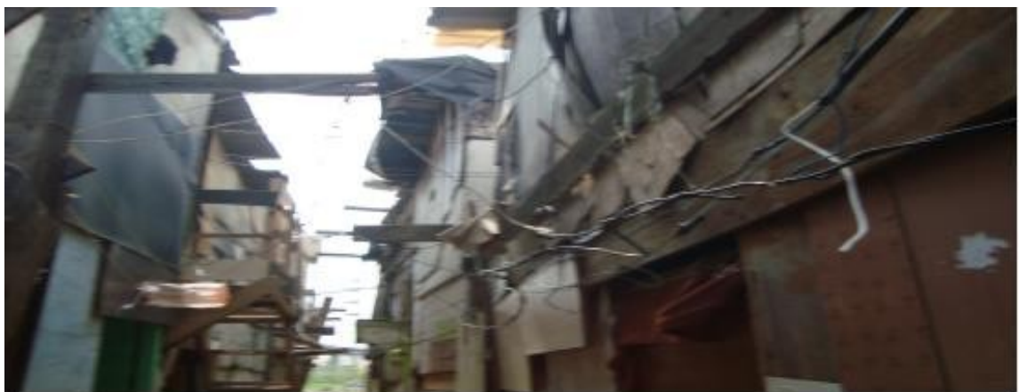
Figura 42 – Favela Esmaga Sapo / fios em que abastassem a energia da comunidade na altura das mãos de uma criança, risco de ferimentos graves
