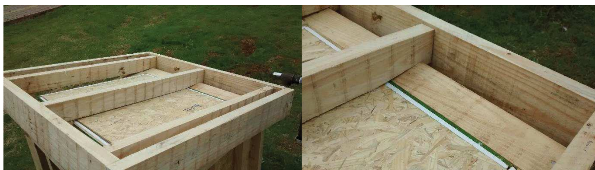
Figura 14 – Estrutura de cobertura: (a) encaixe e fixação da estrutura e (b) detalhe do encaixe
