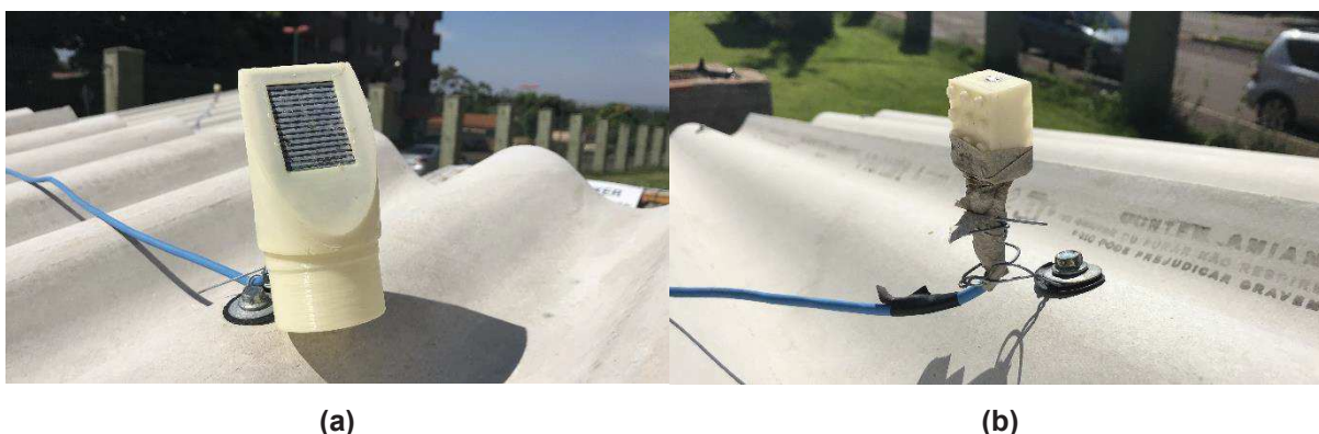
Figura 23 – Detalhes dos sensores: (a) chuva e (b) luminosidade
