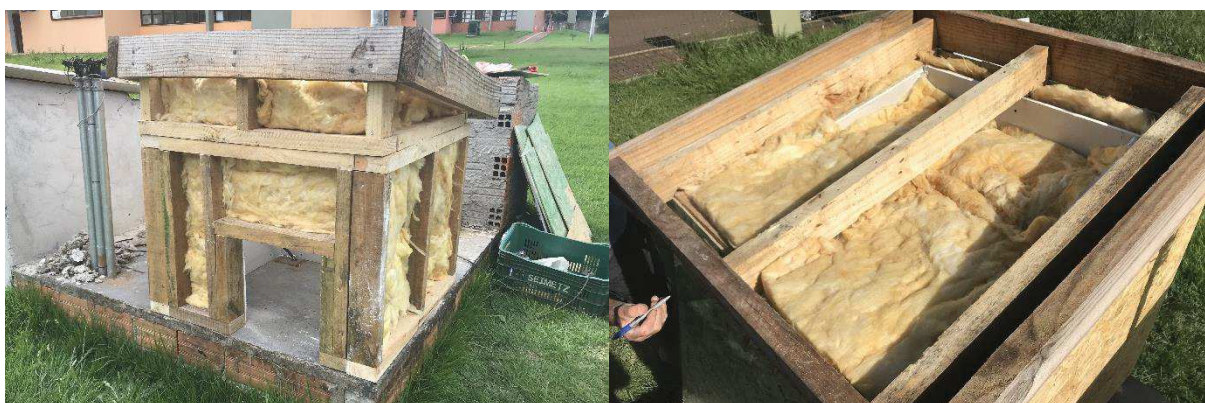
Figura 19 – Isolamento térmico em lã de vidro: (a) aplicação nas faces laterais e (b) aplicação no teto do protótipo
