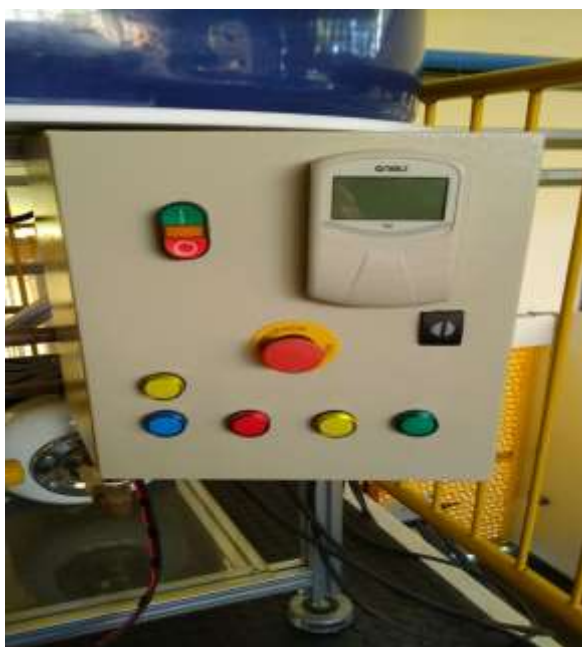
Figura 28 – Painel elétrico de comandos.
