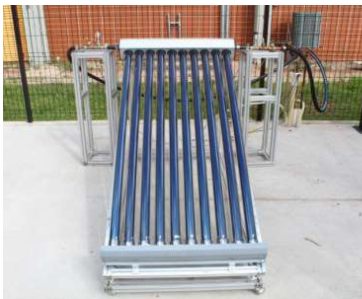
Figura 38 – Coletor solar posicionado e conectado à rede.
