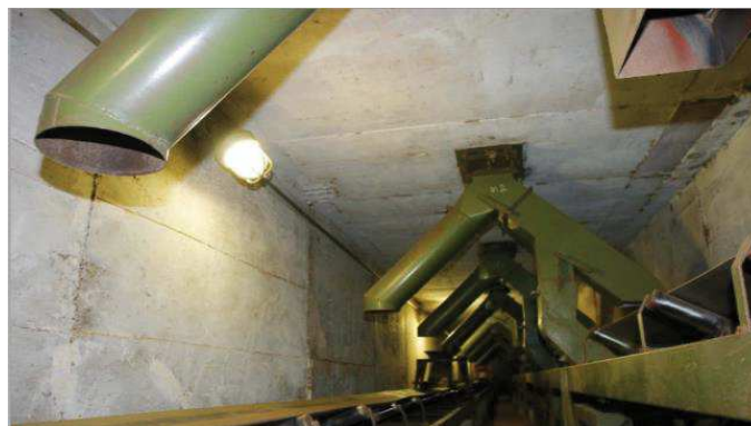
Figura 6. Túneis e esteiras transportadoras.
