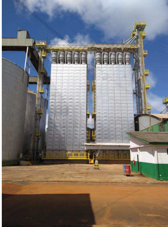
Figura 4. Secadores de fluxo misto 250t/h instalados.
