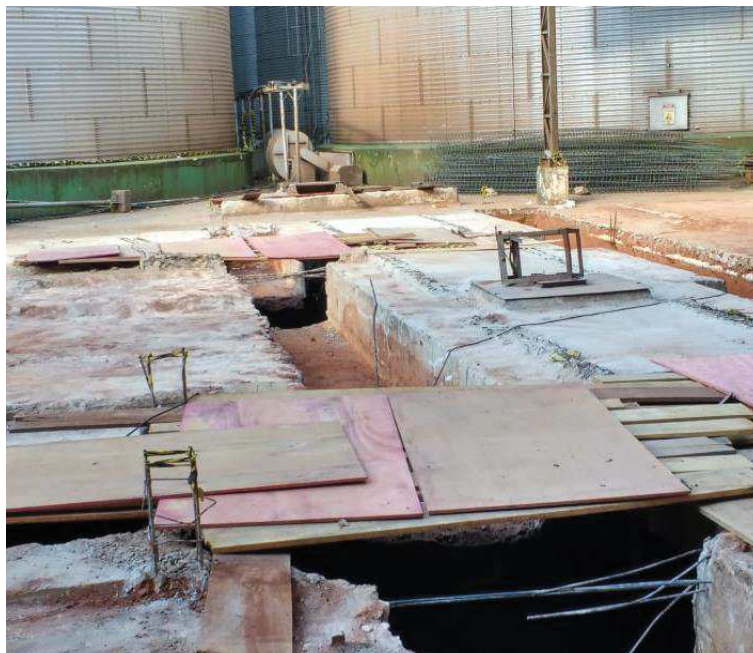
Figura 12. Buracos e valas recém-abertos aumentando riscos no canteiro.
