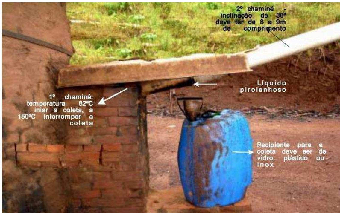
Figura 2. Sistema de condensação dos gases da carbonização instalado em forno convencional
