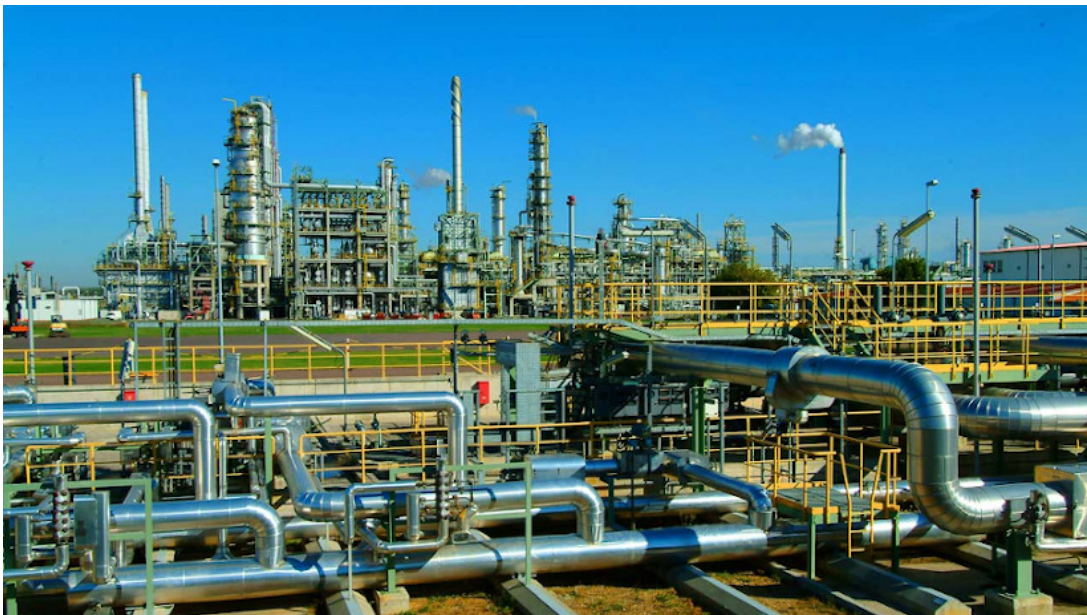
Fotografia 1 – Tubulações para escoamentos multifásicos em uma refinaria de petróleo
