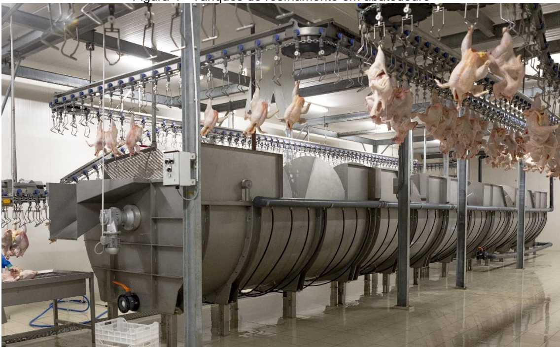
Figura 4 - Tanques de resfriamento em abatedouro
