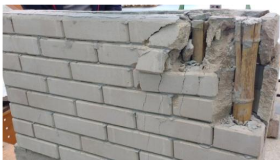
Figura 27 - P 1 - Bambu "rompido" no interior da P 1 Fonte: Autoria própria (2016)
