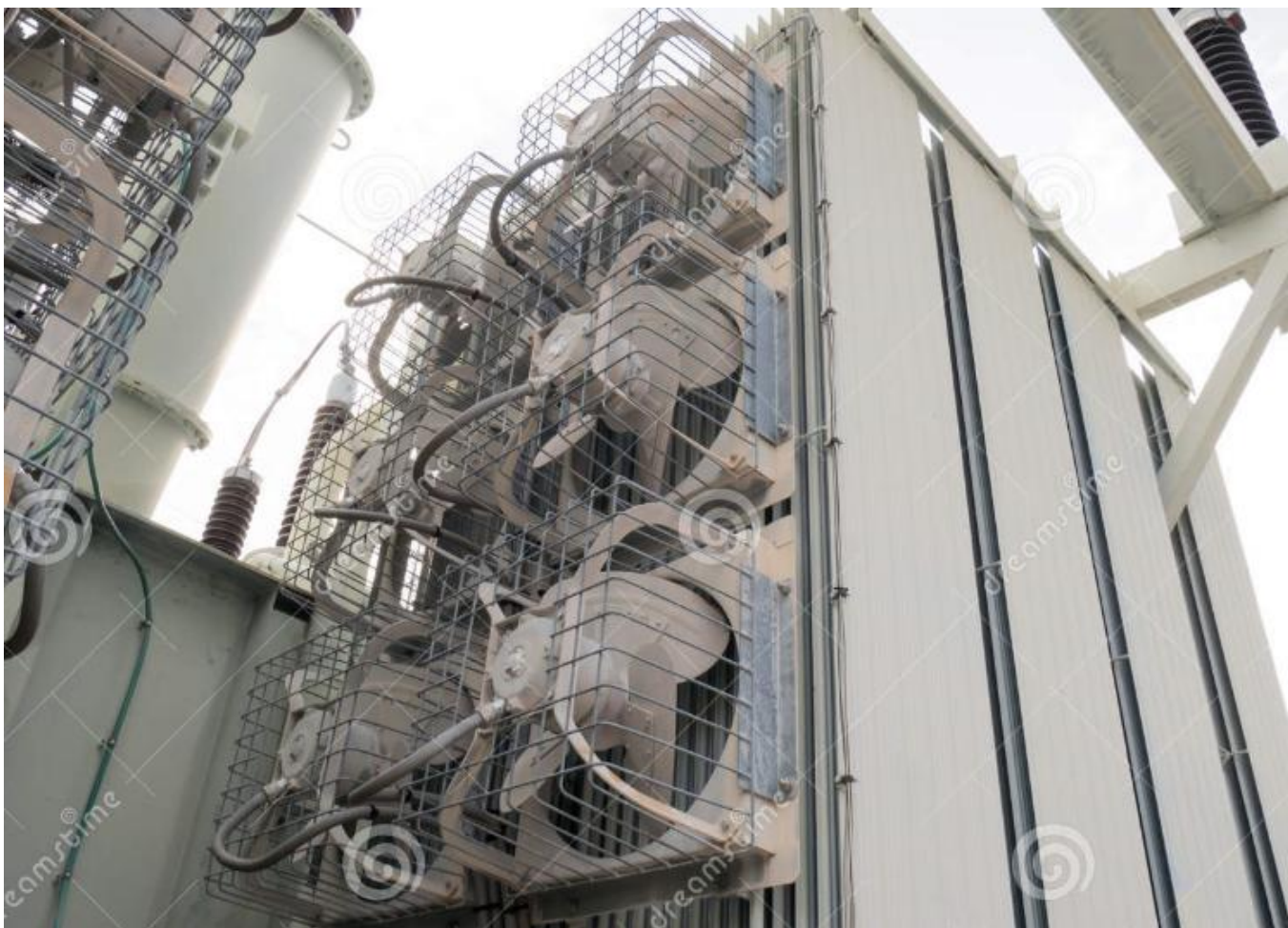
Figura 2 - Sistema de refrigeração com ventiladores
