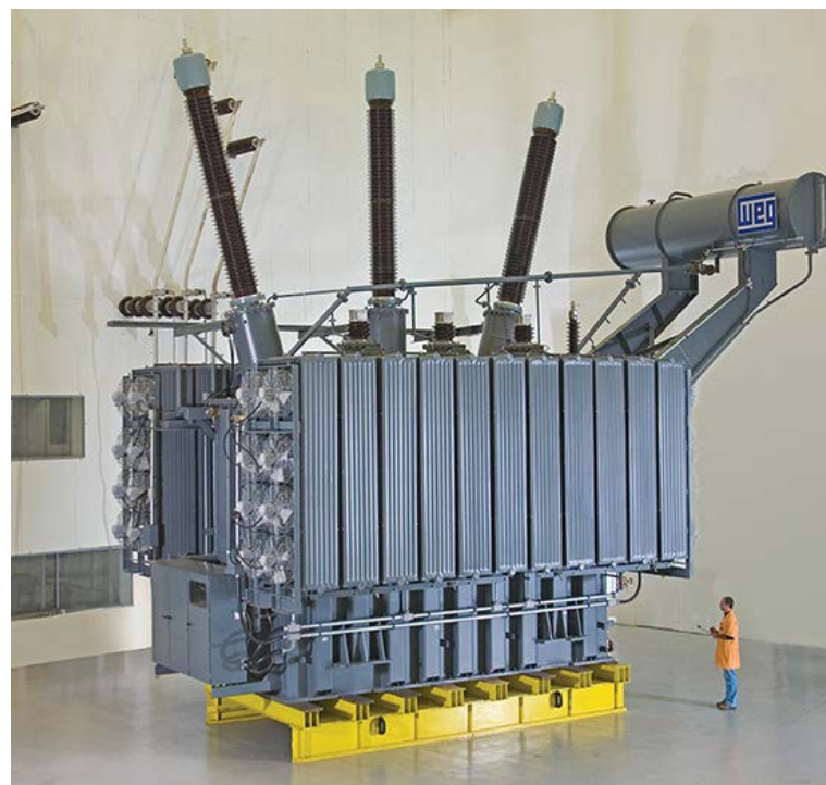
Figura 2.3 – Transformador de potência Fonte: Weg (2013).
