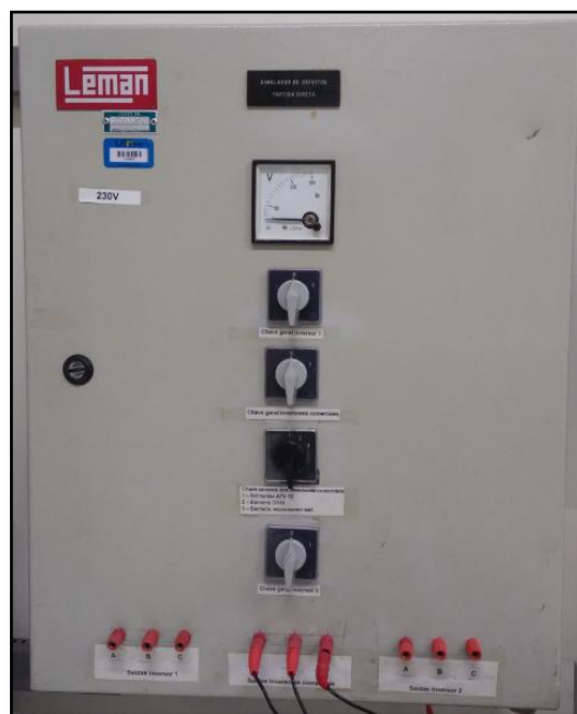
Figura 12 - Painel dos inversores de frequência.
