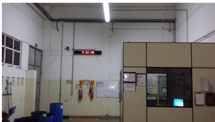
Figura 17: Painel Localizado no Setor de Manutenção Elétrica
