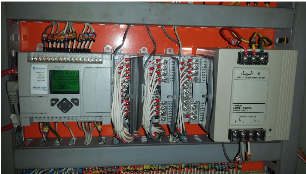
Figura 18: Painel de Comando do Alarme
