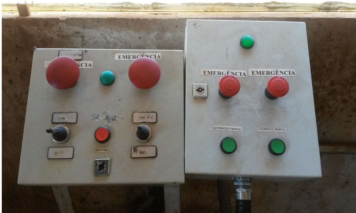
Figura A-8 – Painel de comando manual e automático . Fonte: Próprio autor.
