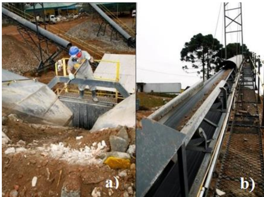
Figura 8 - Processo de reciclagem dos RCCR. a) Separação dos materiais recicláveis. b) Alimentação do britador. Fonte: Lechinhoski (2015).
