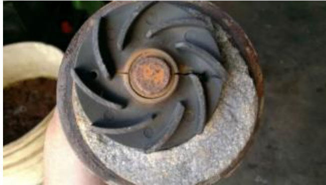
Figura 6 – Rachadura do anel de um rotor
