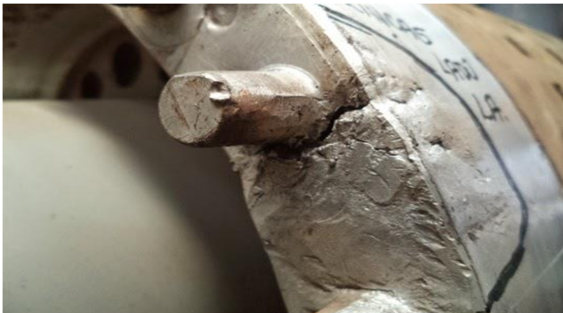
Figura 7 – Barra do rotor danificada.
