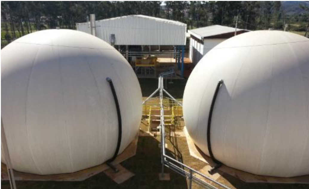
Figura 21 – Sistema de armazenamento do biogás (Gasômetro)
