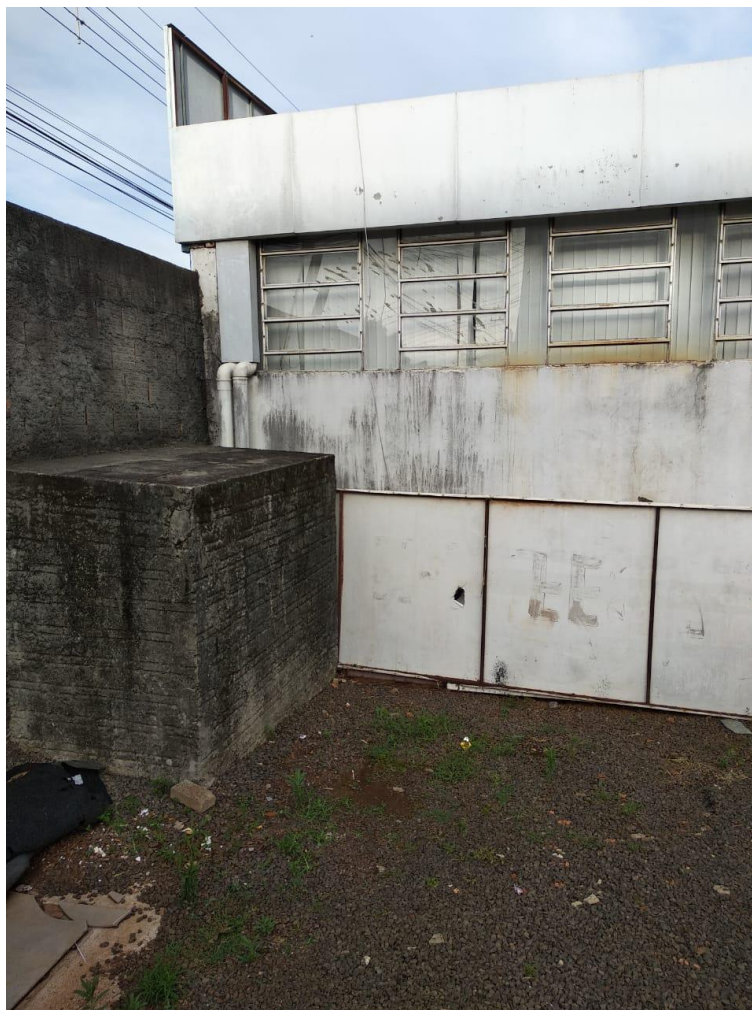
Fotografia 1 - Condutores de água do barracão Fonte: própria (2019)
