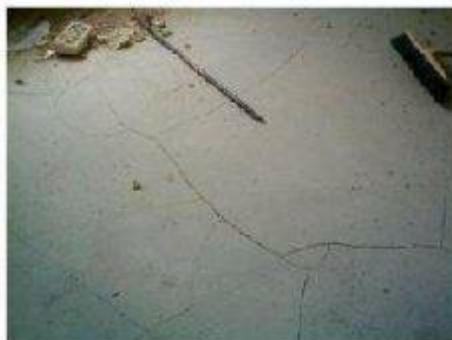
Figura 21: Fissuras de retração plástica em contrapiso de argamassa autonivelante
