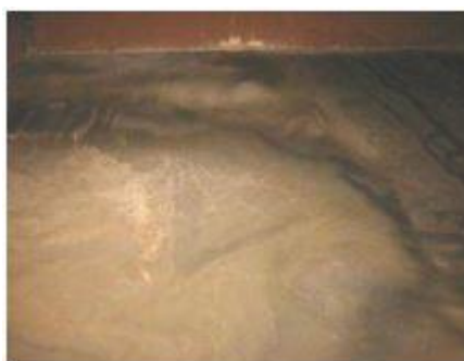
Figura 19: Manchas causadas pelo excesso de água de amassamento
