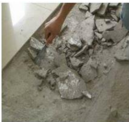
Figura 20: Deslocamento de contrapiso de argamassa autonivelante
