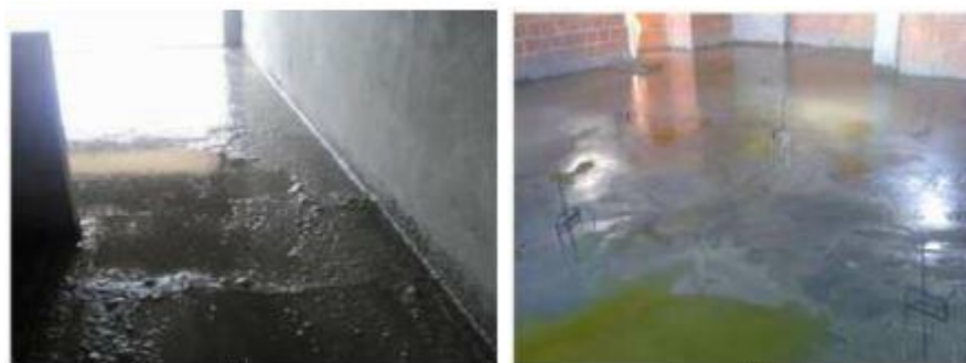
Figura 18: Exsudação da argamassa autonivelante no estado fresco e no estado endurecido
