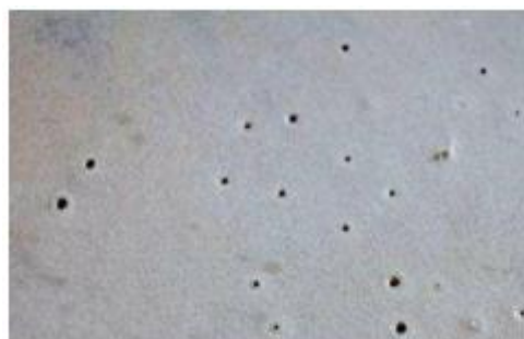
Figura 22: Bolhas superficiais em contrapiso autonivelante
