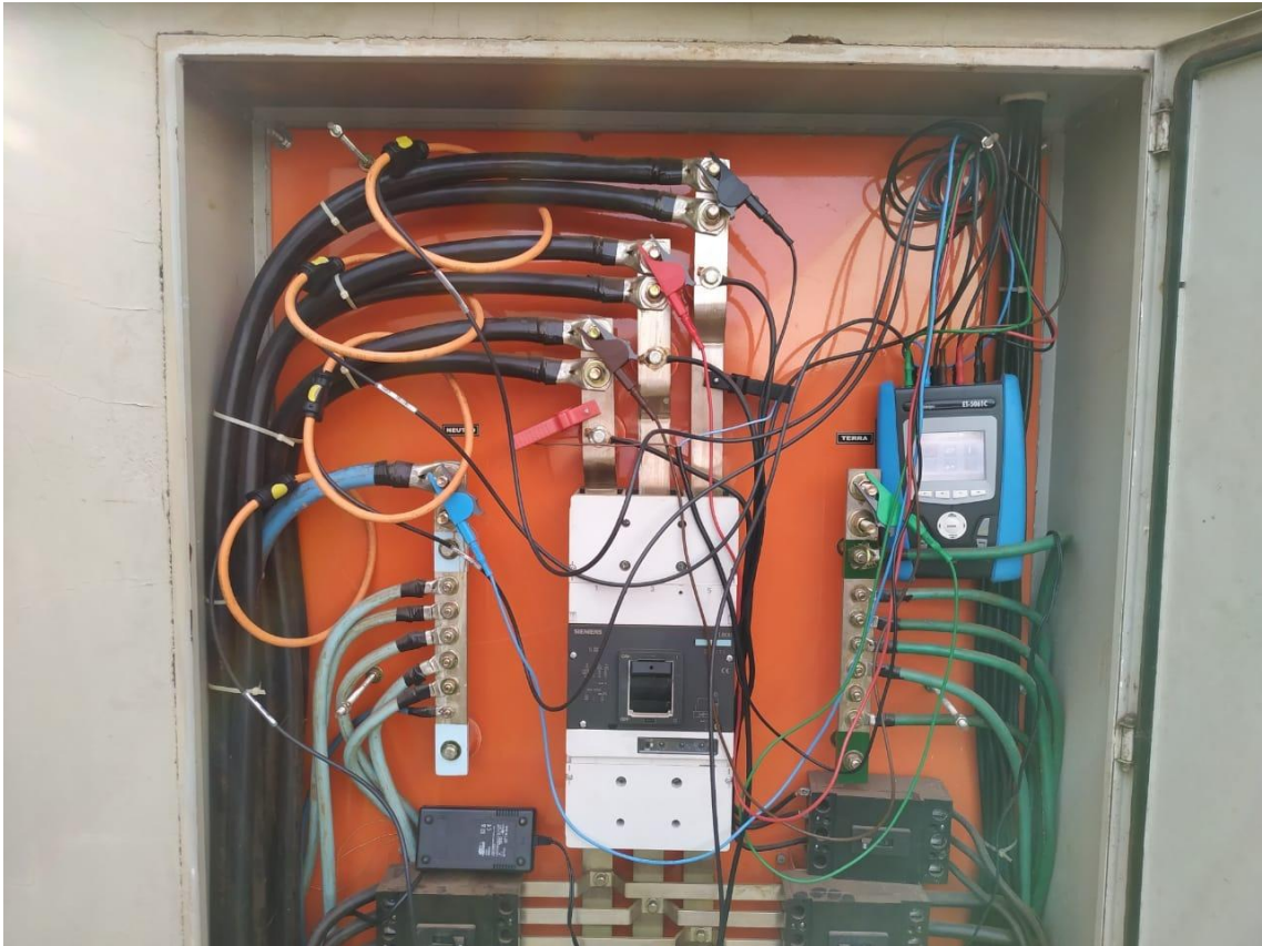
Figura 4: Quadro de energia em que o analisador foi instalado
