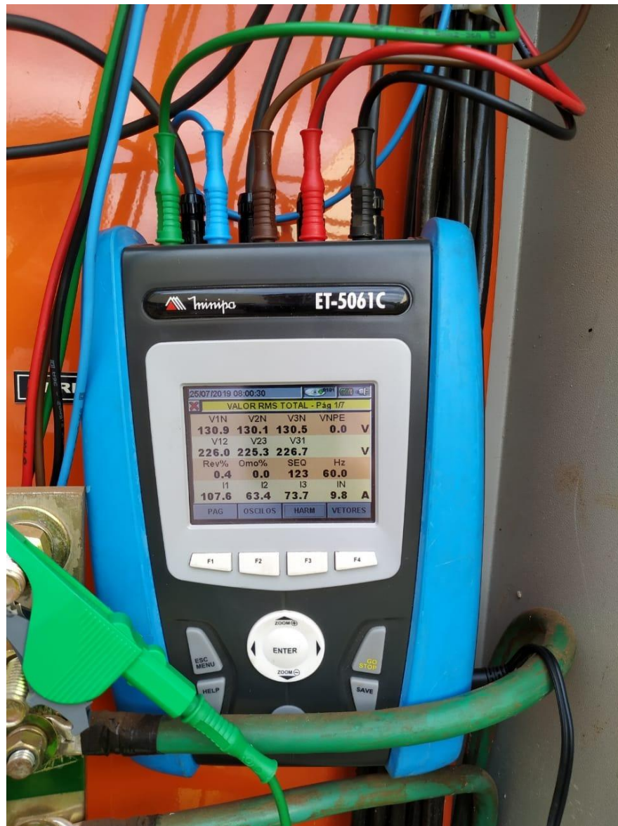
Figura 5: Analisador de energia instalado
