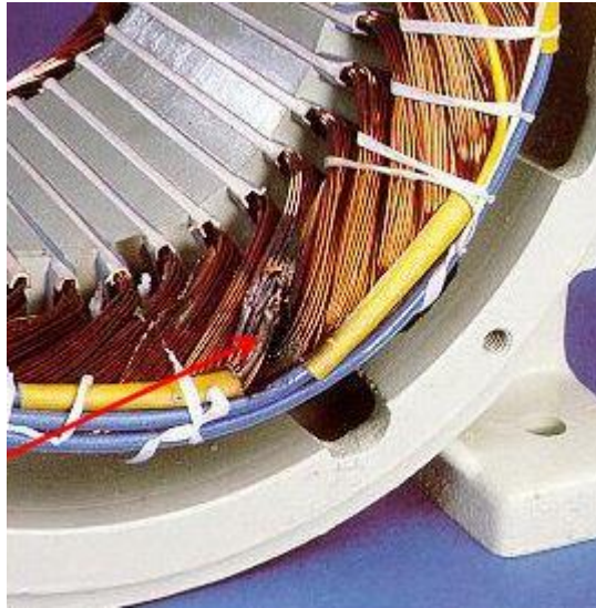
Figura 7 - Falha de estator localizada.
