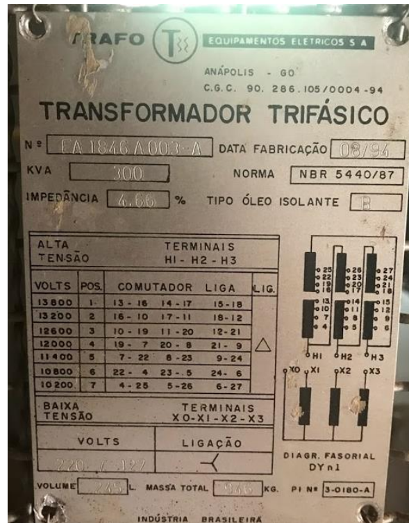
Figura 20 - Placa do Transformador
