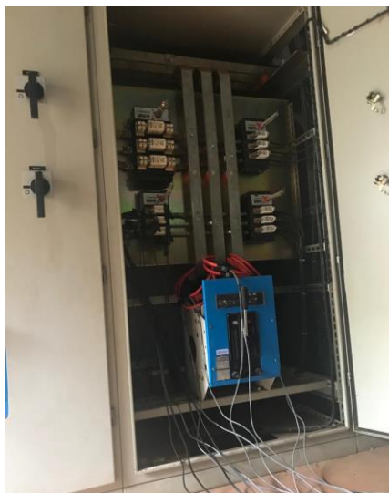
Figura 15 - Painel após conectar sensores de tensão e corrente
