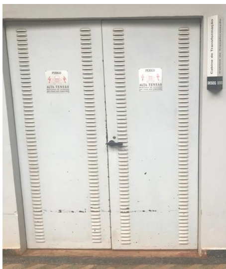
Figura 13 - Entrada da Cabine do Transformador
