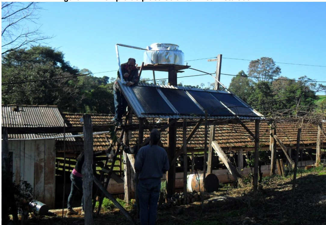
Figura 14 Exemplo de placa solar térmica instalada
