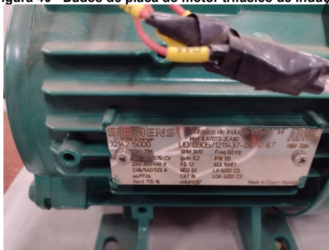
Figura 40 - Dados de placa do motor trifásico de indução
