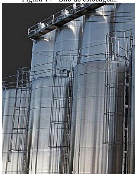
Figura 14 - Silo de estocagem.
