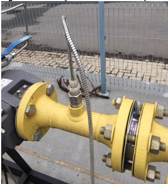
Figura 3 - Instalação do sensor de temperatura para medir a temperatura do GN
