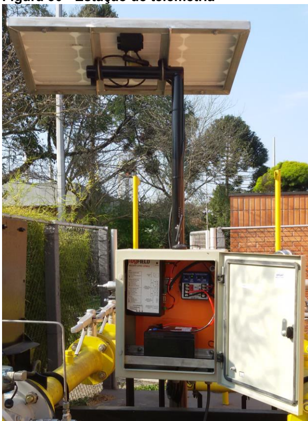
Figura 30 - Estação de telemetria
