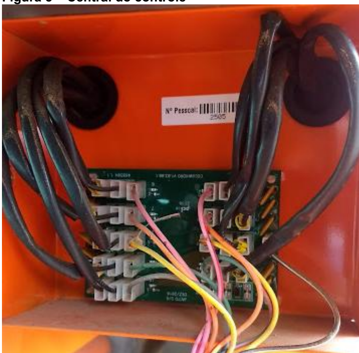
Figura 5 – Central do controle
