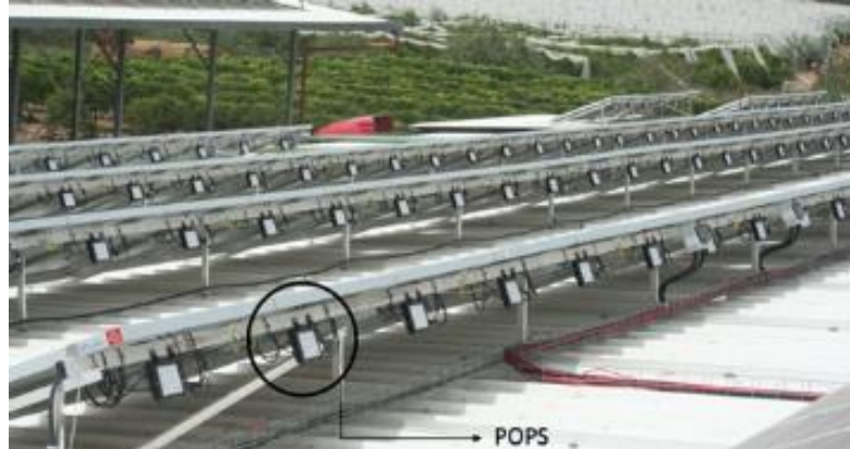
Figura 11 - Exemplo de otimizador de potência instalado, circulado em preto na imagem
