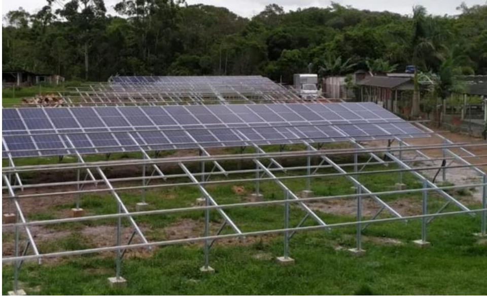
Figura 14 - Exemplo de suporte metálico terrestre fixo com base de concreto
