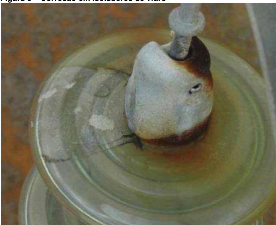
Figura 5 – Corrosão em isoladores de vidro
