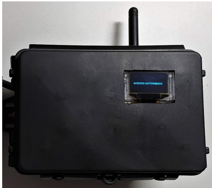
Figura 31 Tranca com a mensagem “acesso autorizado”
