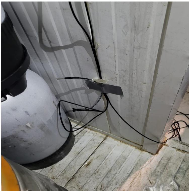
Fotografia 4 - Sensor 2 instalado próximo a porta de acesso
