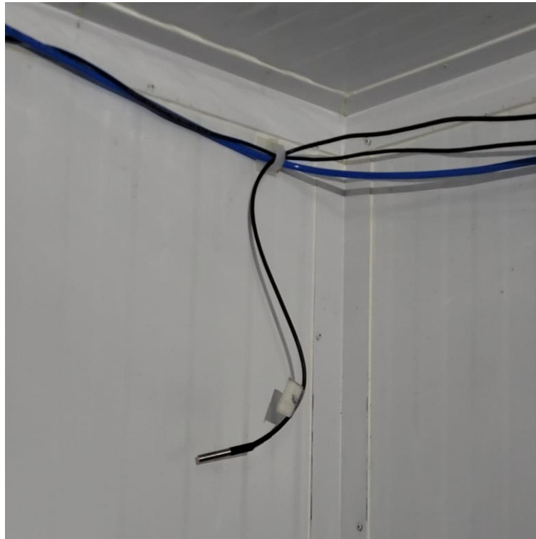
Fotografia 5 - Sensor 04 Instalado acima dos produtos
