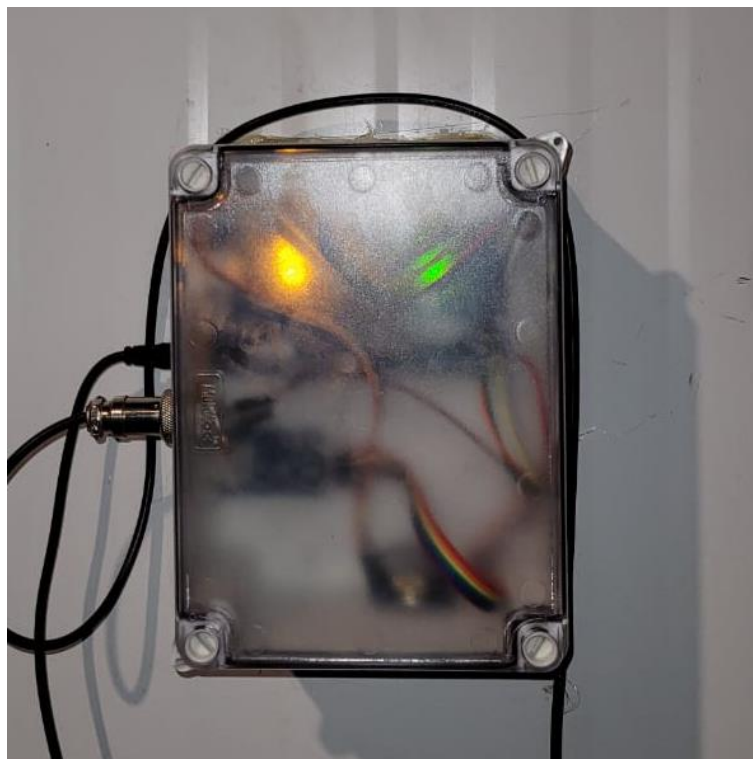
Fotografia 7 - Sistema de aquisição fixo na parte externa da câmara
