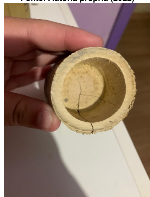
Figura 41- Colmo secundário fissurada parte interna (b)
