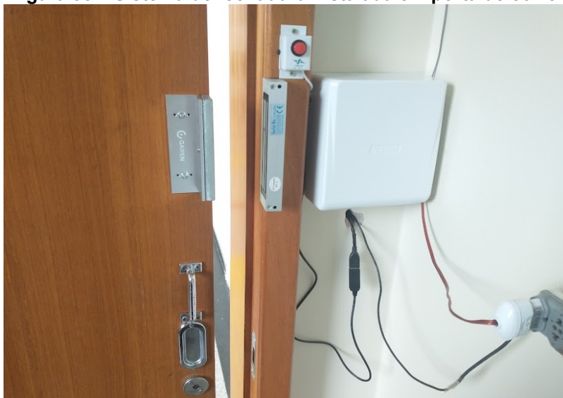
Figura 38 – Sistema de fechadura instalada em porta de correr
