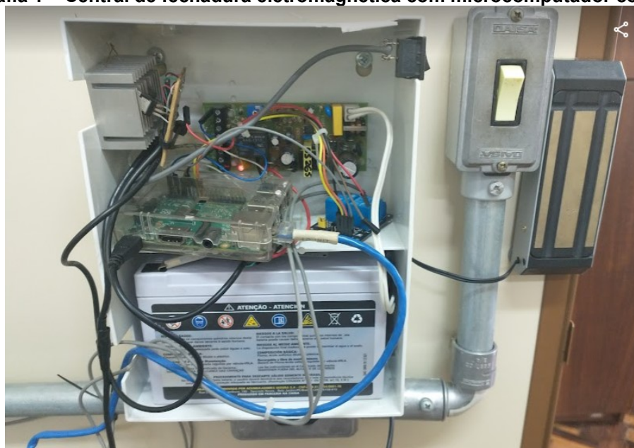
Fotografia 1 – Central de fechadura eletromagnética com microcomputador conectado
