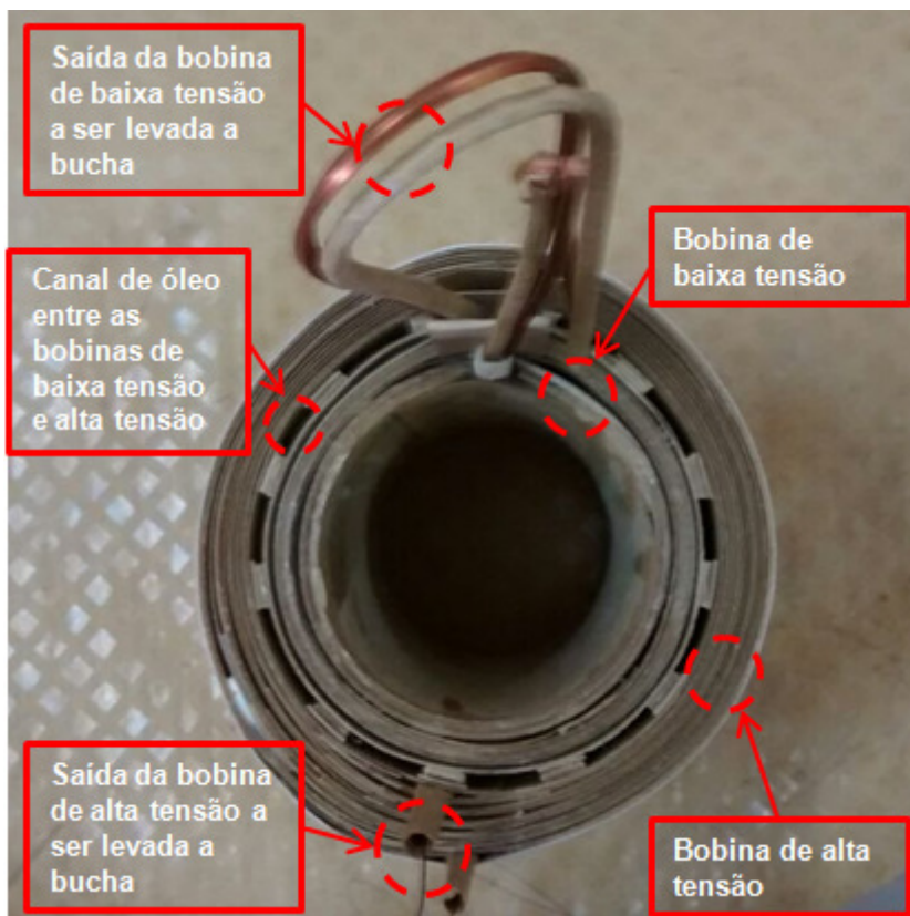
Figura 27 – Bobinas de baixa e de alta tensão montadas. Fonte: Autoria própria.
