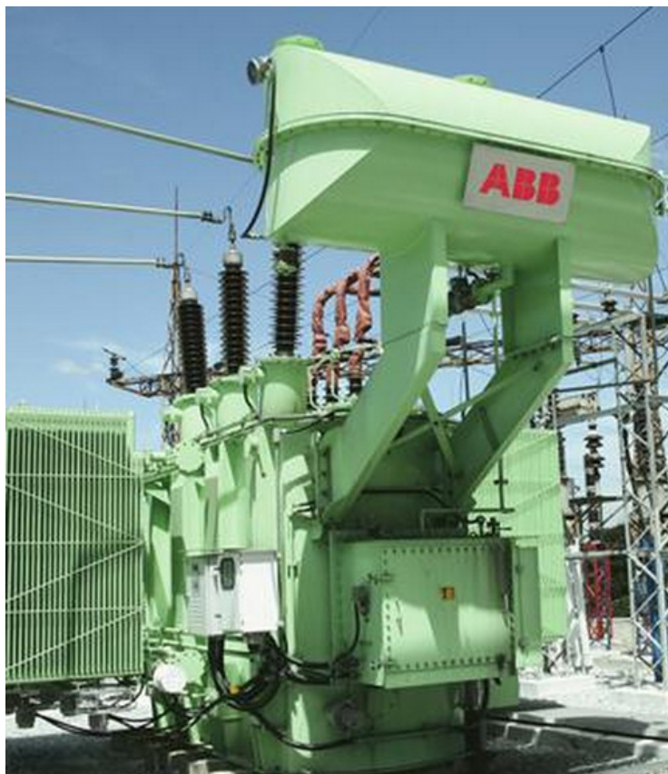
Figura 8 – Transformador verde da CEMIG. Fonte: CEMIG (2006).
