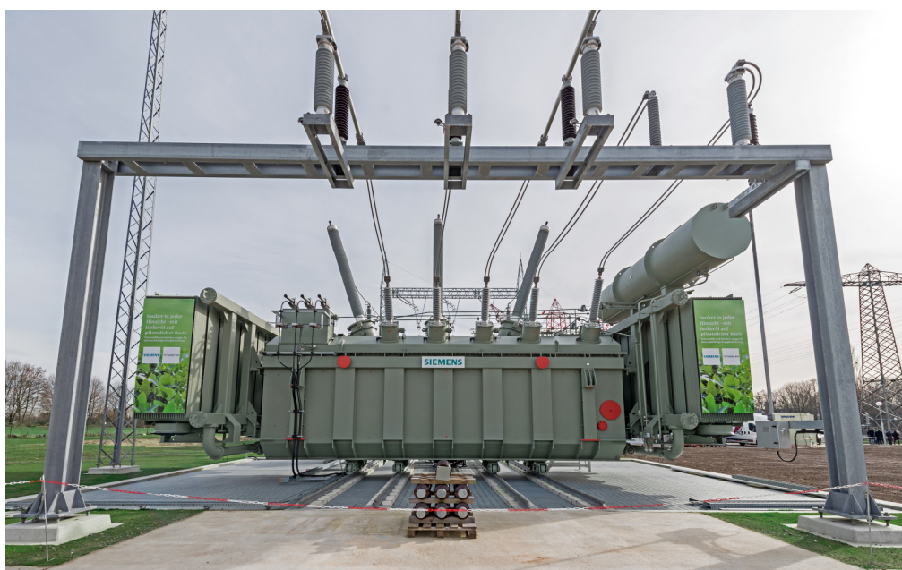
Figura 7 – Transformador com classe 420kV e óleo vegetal em operação. Fonte: Siemens (2014).
