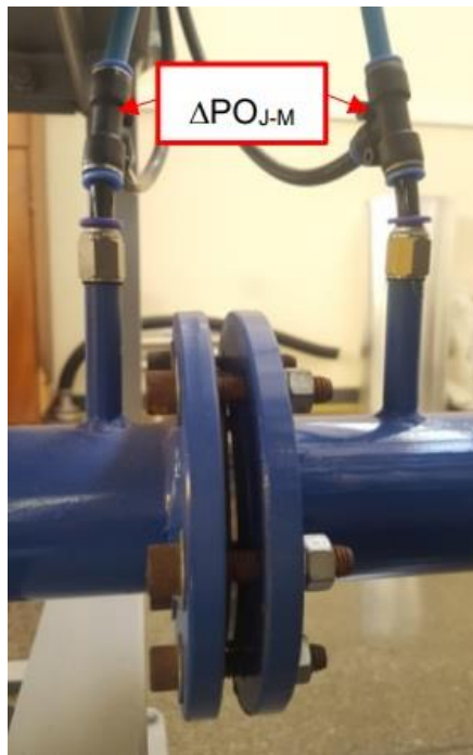
Figura 15 – Medidor de vazão do ar de fluidização da UFRAF, do tipo placa de orifício
