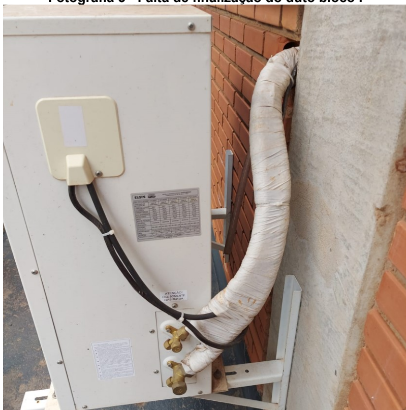
Fotografia 3 - Falta de finalização do duto bloco F
