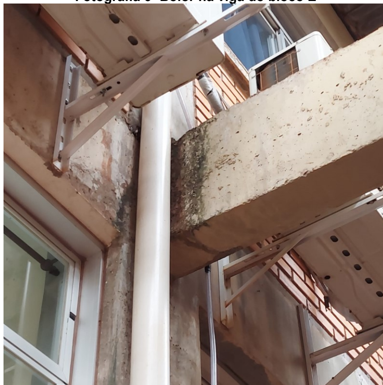
Fotografia 6 -Bolor na viga do bloco E
