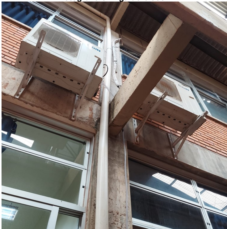
Fotografia 5 -Viga do bloco E
