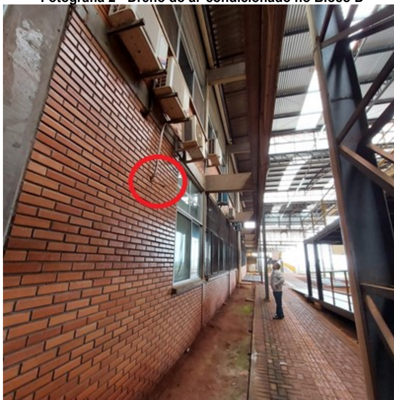
Fotografia 2 - Dreno do ar-condicionado no Bloco D
