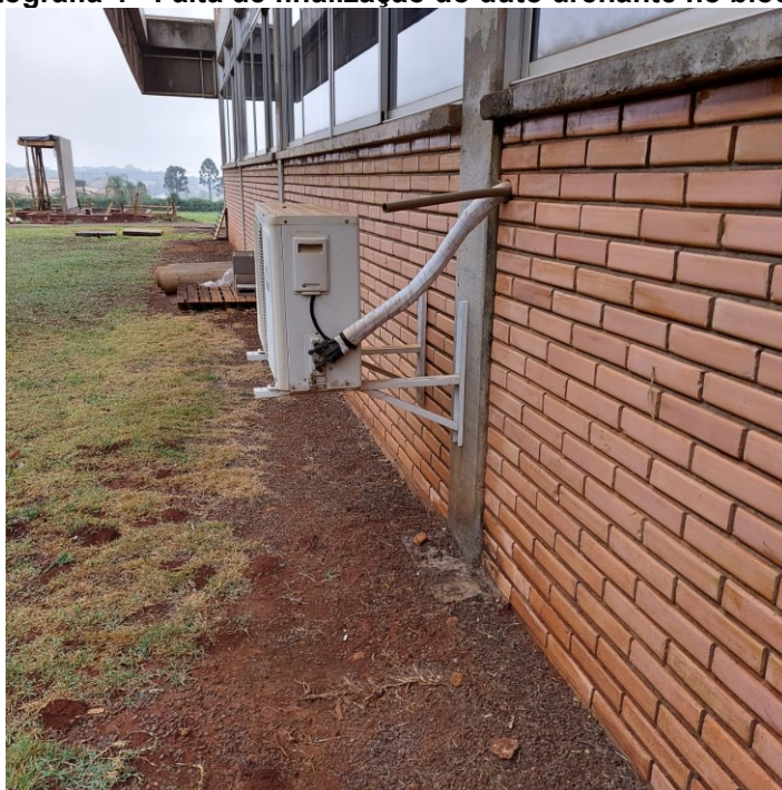
Fotografia 4 - Falta de finalização do duto drenante no bloco H
