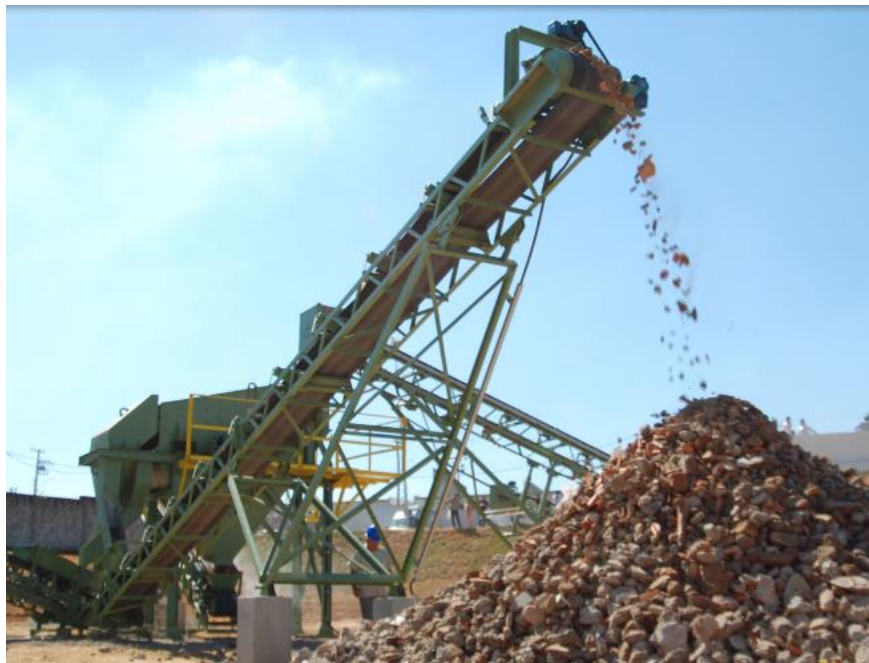
Figura 4: Usina fixa de reciclagem de entulhos
