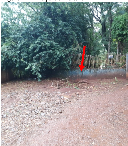
Figura 11 - Poço de visita 5.
