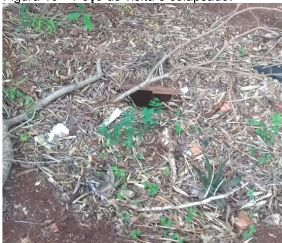
Figura 10 – Poço de visita 5 colapsado.
