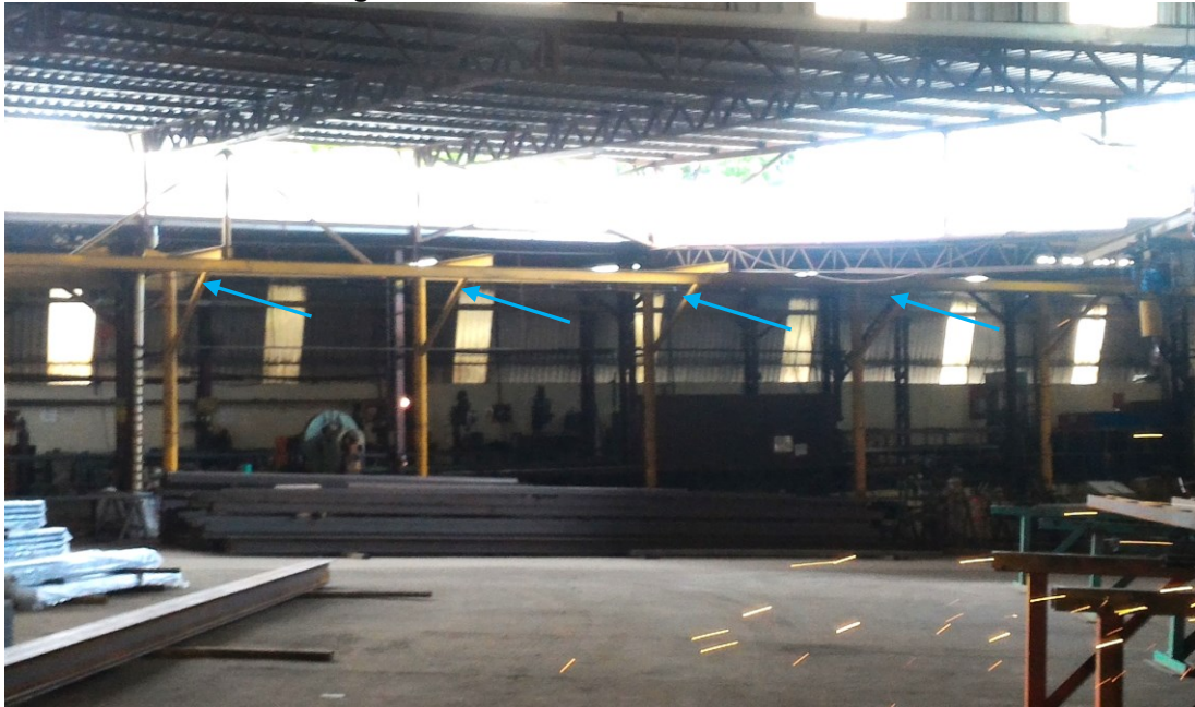
Fotografia 4 - Detalhe do sistema de Monovia
