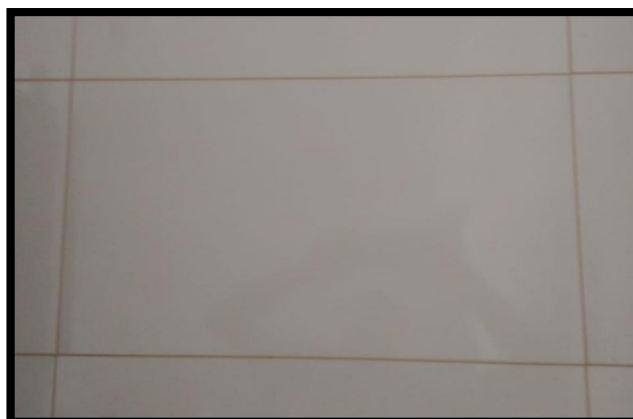
Figura 5 – Azulejo branco da residência
