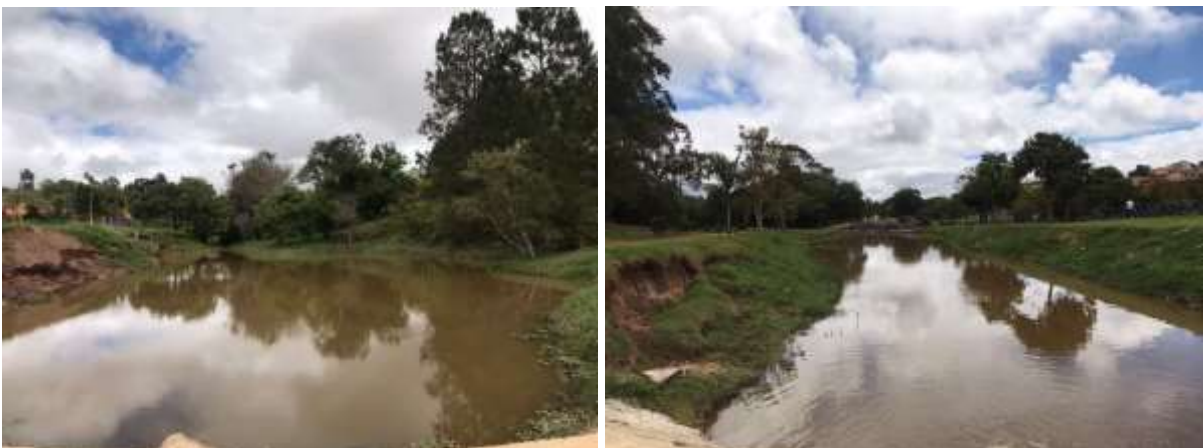
Fotografia 10: Trechos marginais com sinais de erosão
