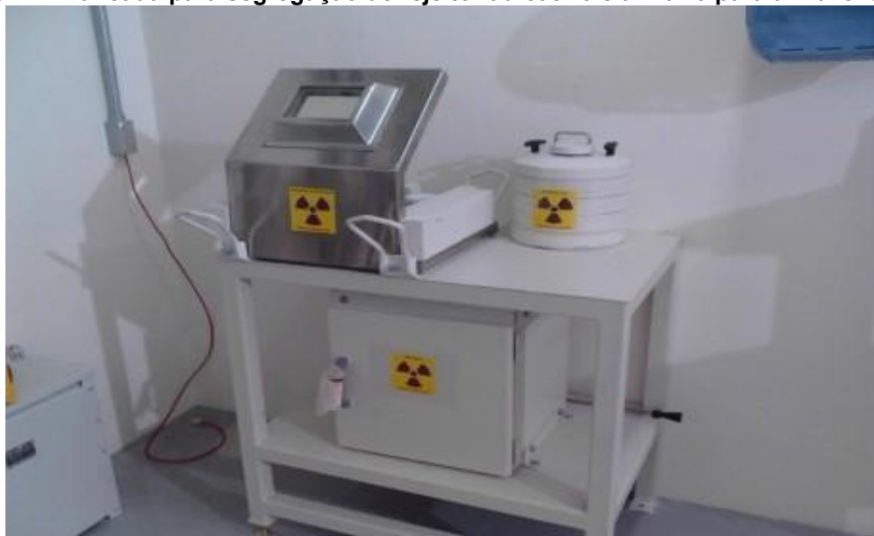
Figura 21 - Bancada para segregação de rejeito radioativo e armário para armazenamento
